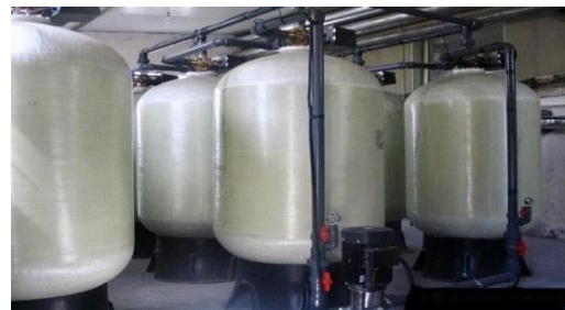
砂濾淨水設備
